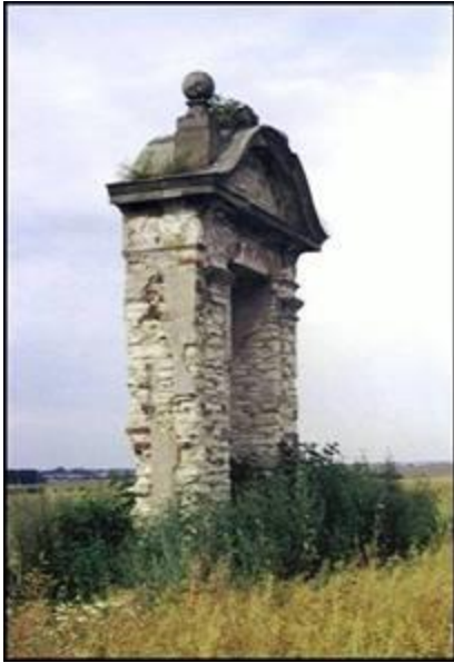
kaple č. 20 před opravou v r. 2000
